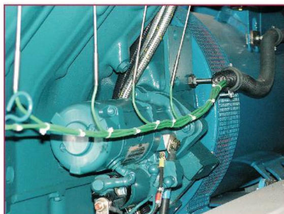
Innenansicht des BHKWs
